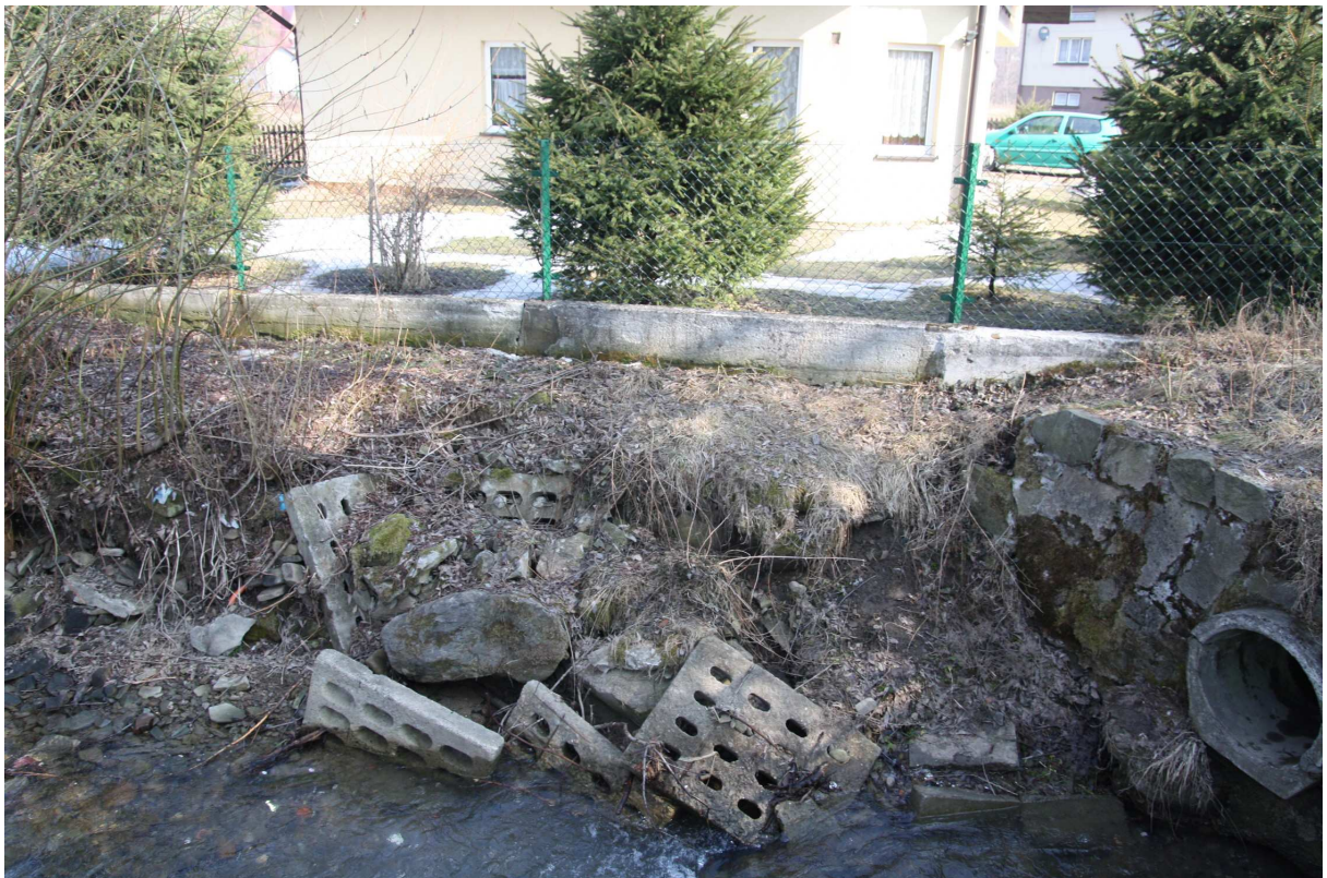
Uszkodzenia skarpy na wylocie z przepustu
