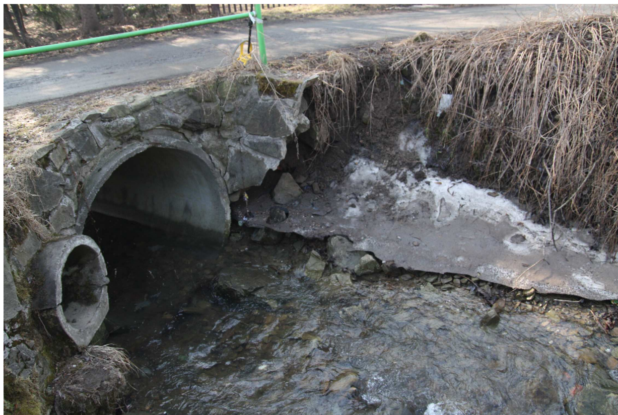
Uszkodzona ścianka czołowa na wylocie z przepustu
