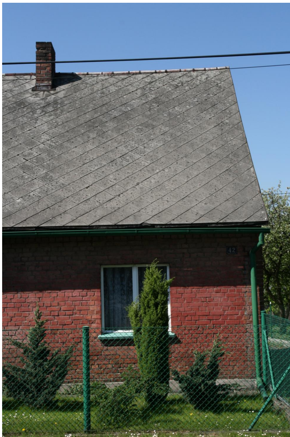
Rysunek 3 Dach budynku mieszkalnego pokryty płytami azbestowymi płaskimi Fotografia Agnieszka Chylak
