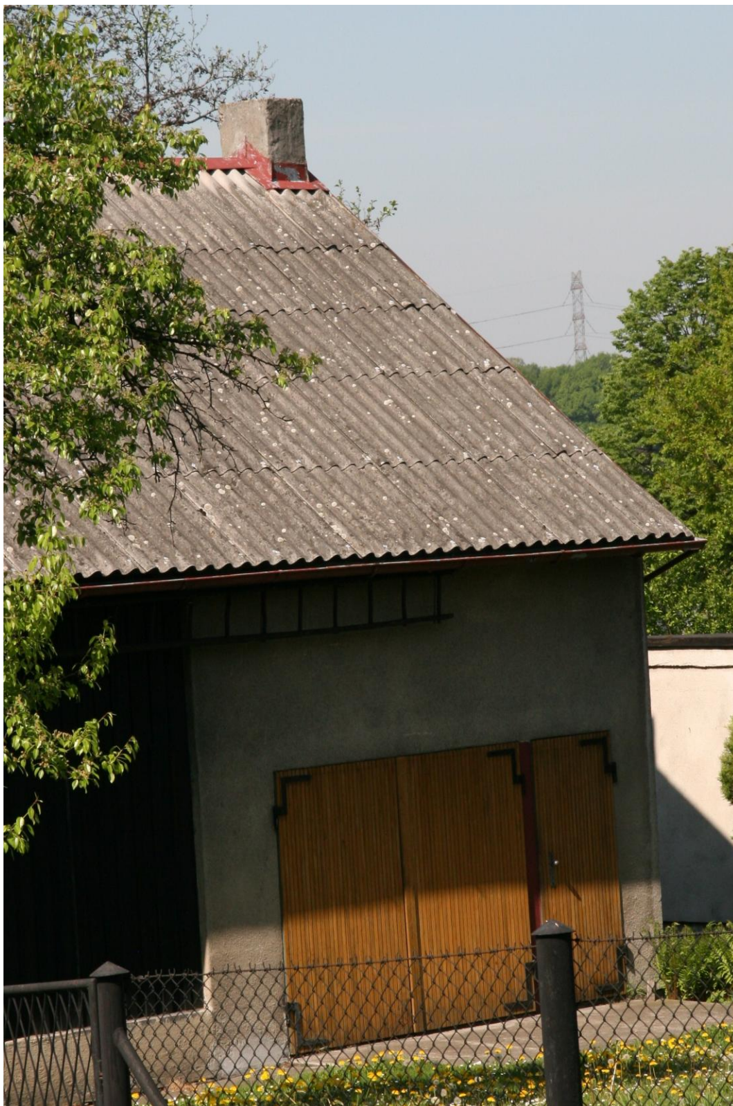
Rysunek 7 Dach pokryty płytami azbestowymi falistymi
