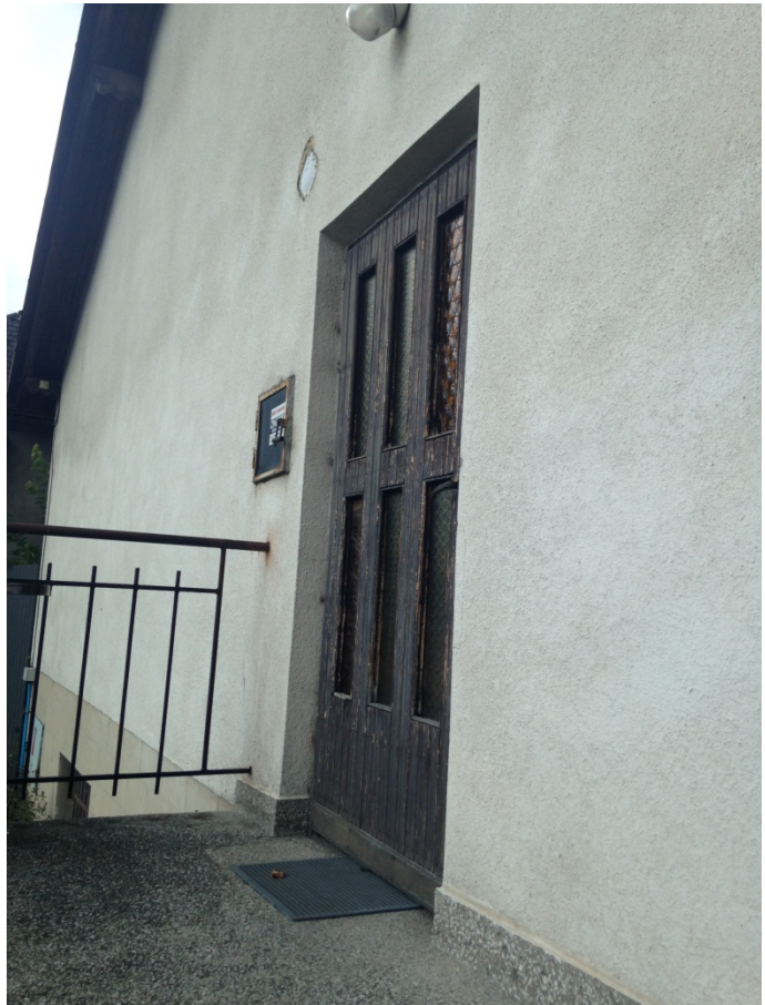
Wyeksploatowana stolarka drewniana
