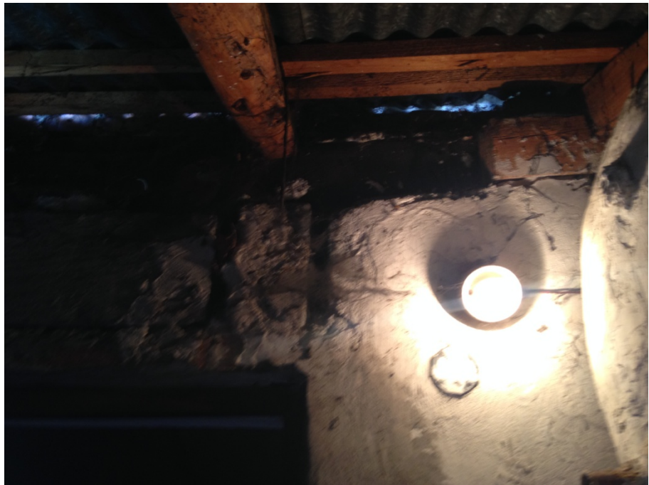
Nieszczelności pokrycia dachu
